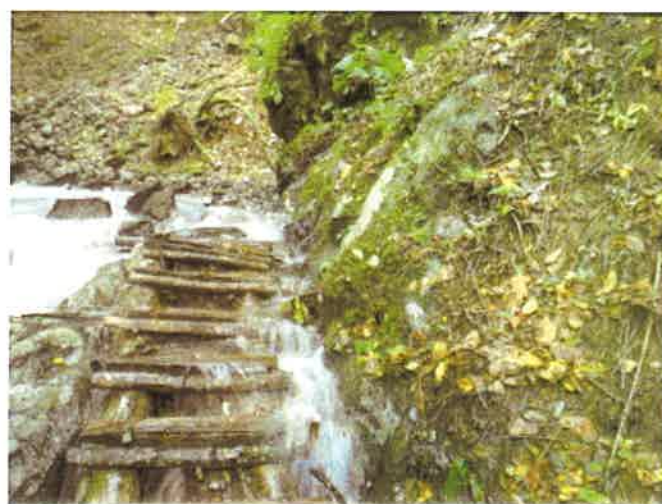
①丸太橋浸水：起点250m～500mの間
